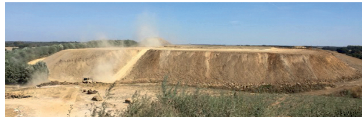
Site d'ECT de gestion et de réutilisation des terres excavées à Moissy-Cramayel.
